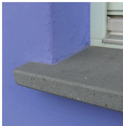
Steinfensterbank. Es fehlt die Wasserführung.
