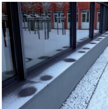
Fensterbankhalter als Wärmebrücke. Abhilfe schafft der nachträgliche Fensterbankeinbau.
