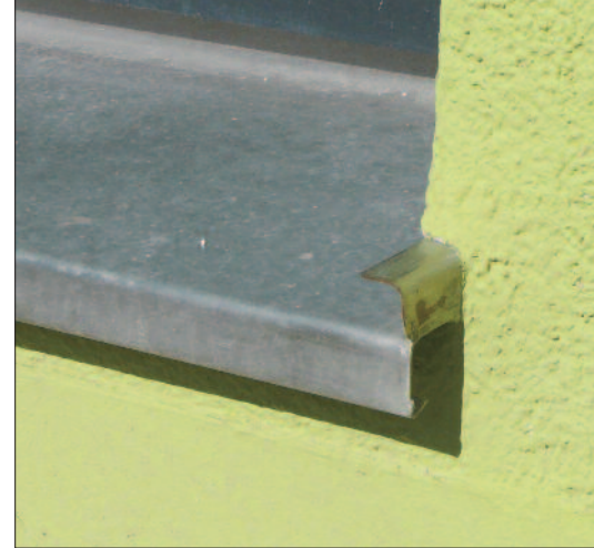
Die Fensterbank als Spenglerlösung überträgt mangels Dehnfähigkeit alle Kräfte auf die Putzschicht des WDVS
