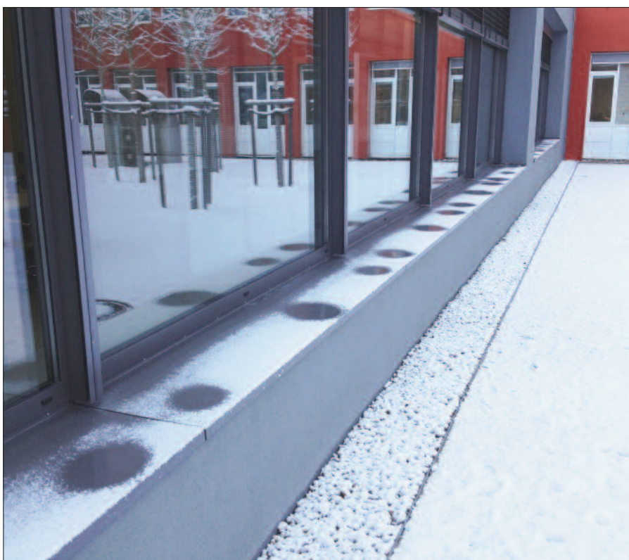
Auswirkungen auf der Fensterbank ohne thermische Trennung
