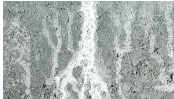
Neubeton mit starken Flecken
