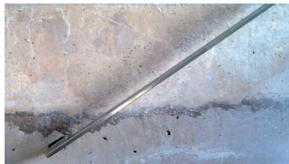
Neubeton mit Betonierfehlern, die nachgespachtelt werden müssen
