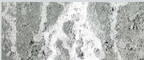
Nieuw beton met ernstige onvolkomenheden
