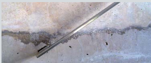
Nieuw beton met gebreken die moeten worden opgevuld
