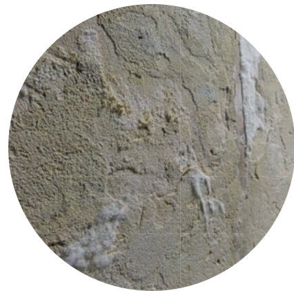
Abplatzungen und Salzausblühungen; hoher Salzdruck
