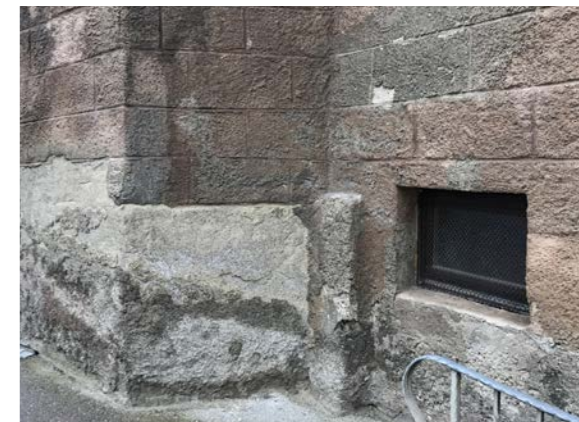
Schadensbilder wie z.B. Salzausblühungen und Feuchtflecken
