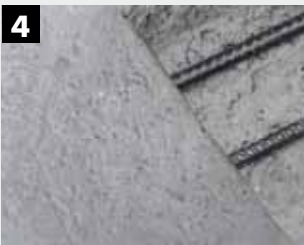
4 Gaten vullen met minerale KEIM Concretal-Universseelmortel in de bevochtigde ondergrond, toepassing zonder speciale corrosiebescherming en hechtbrug. Laagdiktes van 0,5 – 5 cm mogelijk, vanaf ongeveer 2,5 cm in meerdere lagen aanbrengen. KEIM Concretal-Universseelmortel kan direct gladgepleisterd worden.
