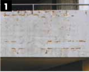
1 Typische schade bij onvoldoende beschermd beton
