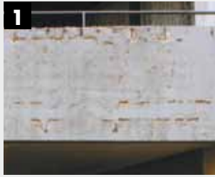
1 Typische schade bij beton dat onvoldoende beschermd is
