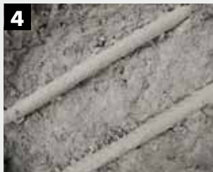
4 Dubbele beschermingslaag op het ontroeste staal met KEIM Concretal-MKH. Droogtijd minimaal 3 uur. Eerste laag wordt onmiddellijk na het ontroesten aangebracht.
