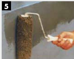
5 Dubbele verflaag met KEIM Concretal-W, a) verdunde onderlaag b) onverdunde deklaag met borstel, roller of airless spuit
