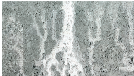
Neubeton mit starken Flecken
