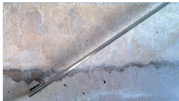
Neubeton mit Betonierfehlern, die nachgespachtelt werden müssen
