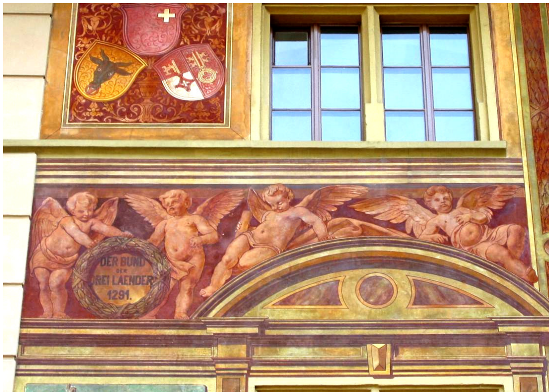
Sich milchig abzeichnende Verglasungen aus früheren Interventionen am Rathaus Schwyz. Sie sind irreversibel. Solche Malereien bedürfen eines fachkundigen und behutsamen Unterhalts, gerade um Verglasungen, Überfixierungen oder Ausblühungen zu vermeiden und die Beständigkeit und Leuchtkraft der Malerei, wie hier auch 130 Jahren nach ihrer Entstehung, zu erhalten. Bild: Fontana&Fontana, Jona
